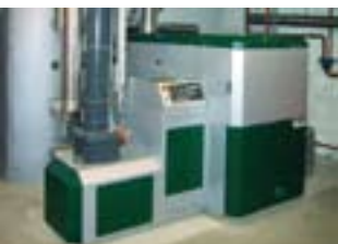
Straßenmeisterei Gloggnitz Pelletsanlage 150 kW
