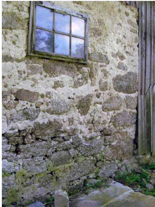
Sockel einer Bruchsteinmauer mit Verdunstungszone (links)
