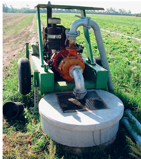
Abbildung 2: Tragsichere Abdeckung mit angepasster Ausnehmung für die Saugleitung.
