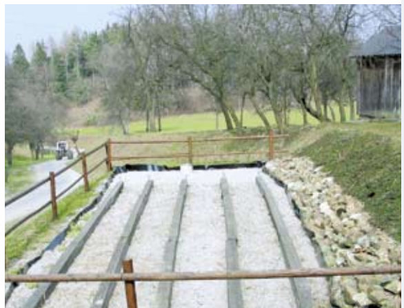
Pflanzenkläranlage für 12 EW
